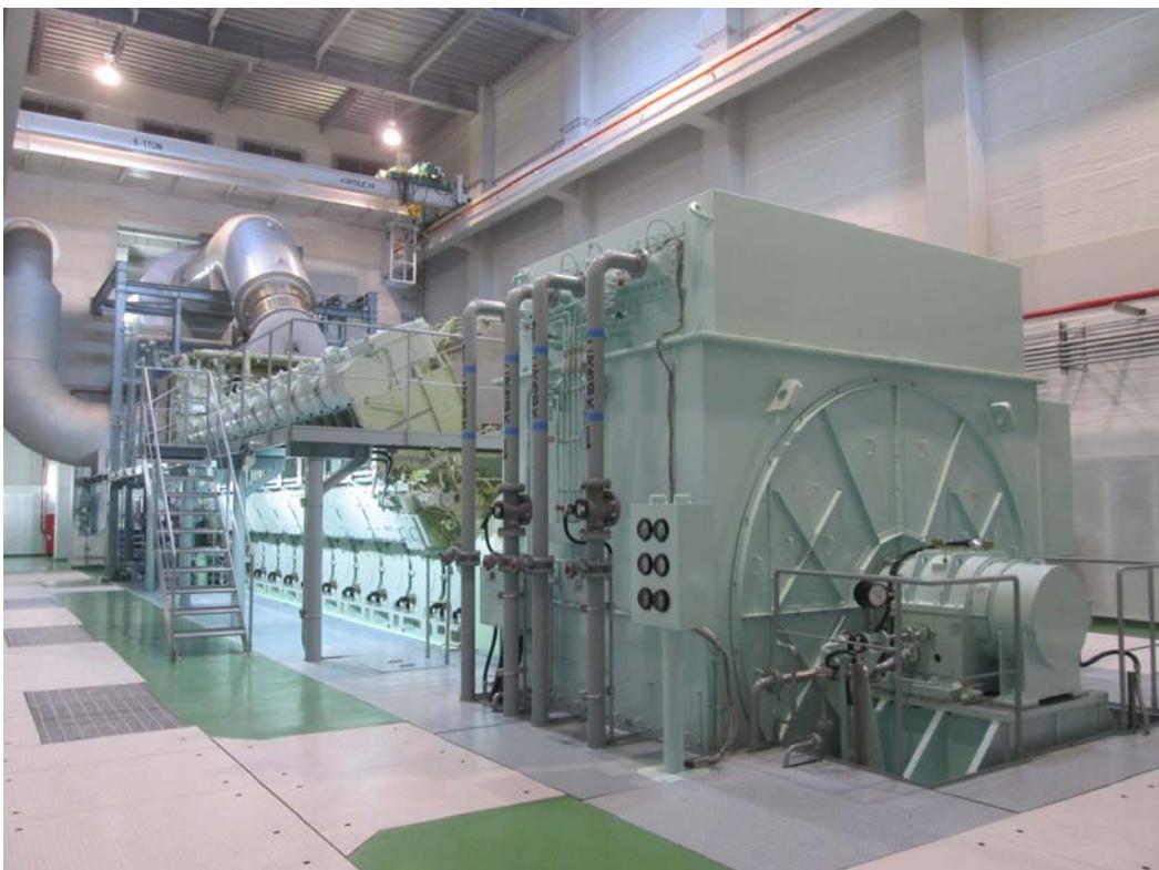
6号機発電設備
