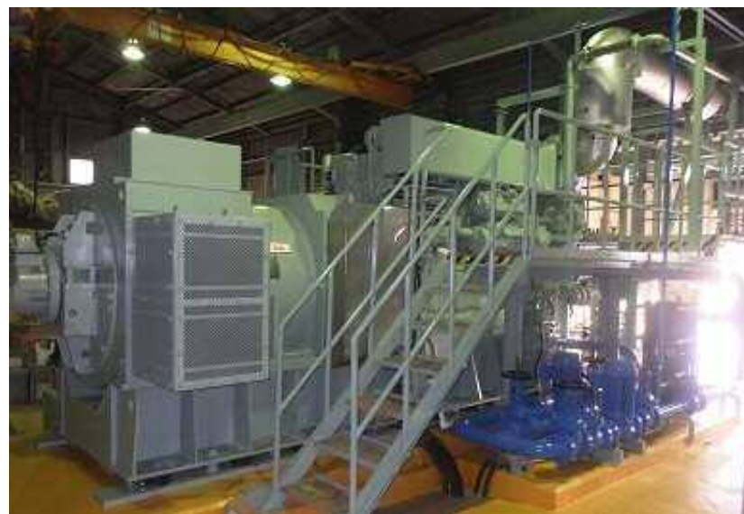
◀ 高効率の内燃力発電機 ▶ 【与那国発電所 10号機】
