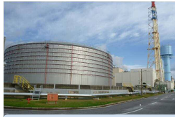
「石川火力発電所タンク」
