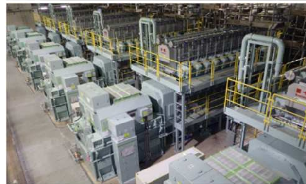
← ガスエンジン発電設備
