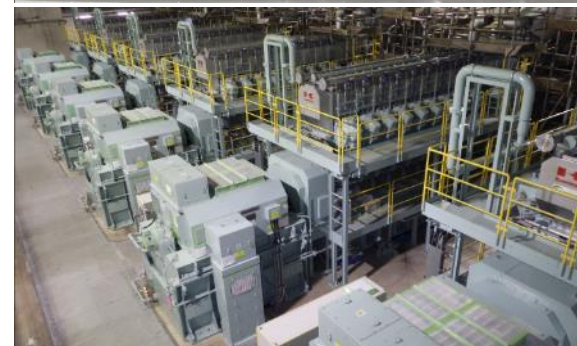
← ガスエンジン発電設備
