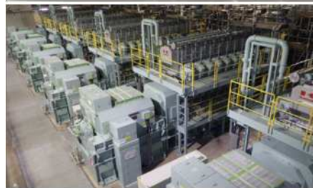
← ガスエンジン発電設備
