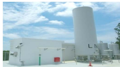
【サテライト設備】 (名称:アワセ供給センター)
