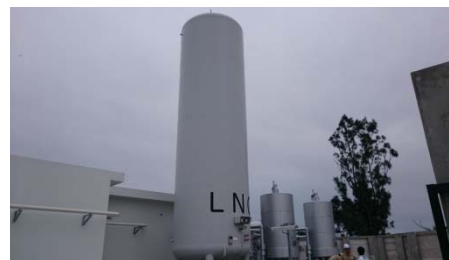
【サテライト設備】 (名称:アワセ供給センター)
