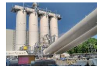
バイオマス混焼設備
