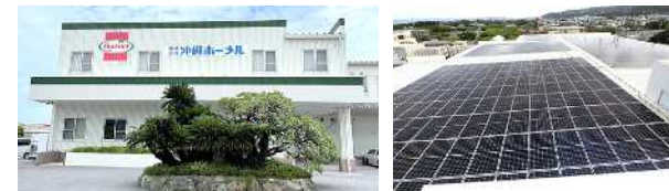
株式会社沖縄ホームル (2023年6月運開) ■太陽光発電設備:185kW ■蓄電池:13.5kWh ■CO 2 削減量:254t/年
