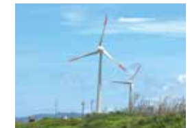
▲伊江島第二風力発電所
