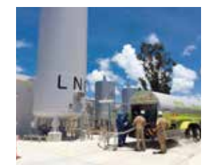
▲アワセ天然ガス供給センター
