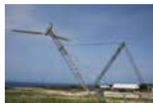
▲波照間可倒式風力発電設備（傾倒時）
