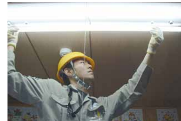
▲保育園や一人暮らしのお年寄り宅などの電気設備の無料点検、修理
