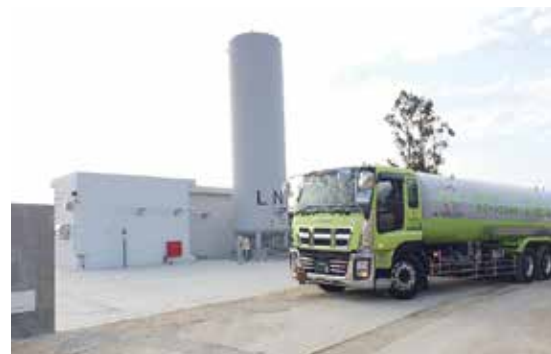
アワセ天然ガス供給センター
