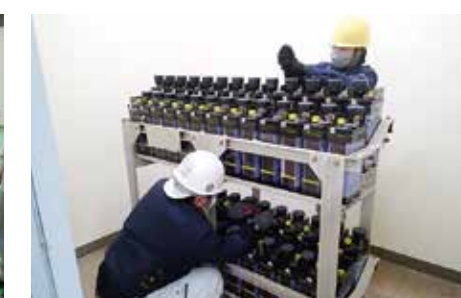
直流電源装置(蓄電池取替)
