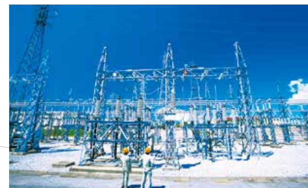
柴野比変電所
