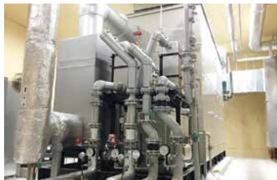
自家用発電システム
