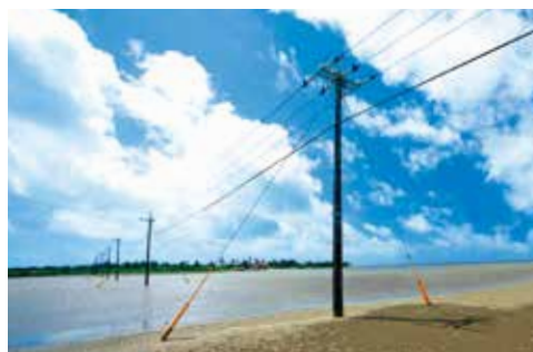
由布島へ続く配電線路
