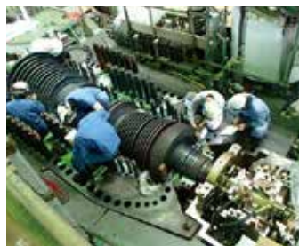
発電所のタービン点検
