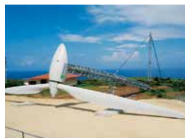
可倒式風力設備（傾倒時）【粟国島】
