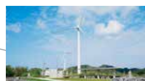
大宜味風力発電実証研究設備
