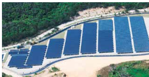
安部メガソーラー実証研究設備
