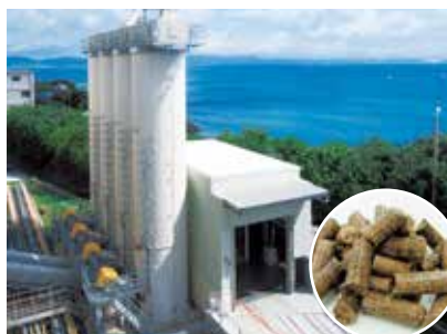
木質バイオマス供給設備
