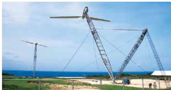
波照間可倒式風力発電設備
