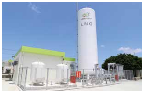
牧港天然ガス供給センター：(株)プログレッシブエナジー （設計：(株)沖縄エネテック・施工（基礎工事）：(株)沖縄開発
