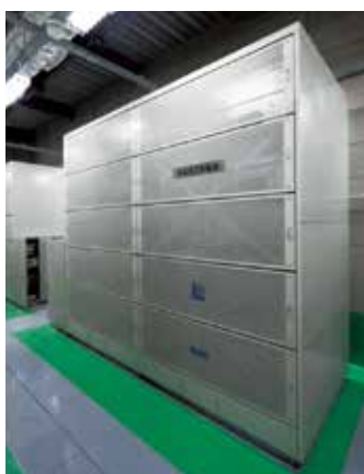
宮古島メガソーラー 実証研究設備 (NaS電池)
