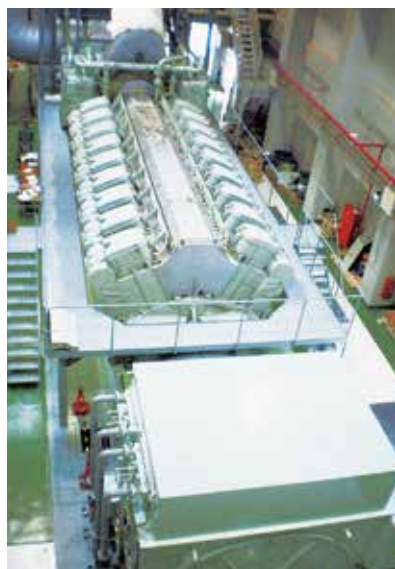
石垣第二発電所 (ディーゼル発電機)
