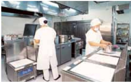
業務用電化厨房機器を導入した福祉施設の厨房
