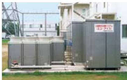
蓄熱式空調システム
