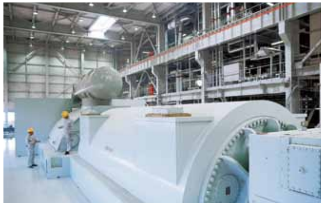
蒸気タービン
