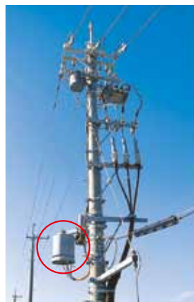
電柱に取り付けられた遠制御開閉装置
