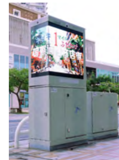
地上機器の上に設置されたデジタルサイネージ
