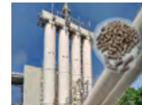
木質バイオマス供給設備
