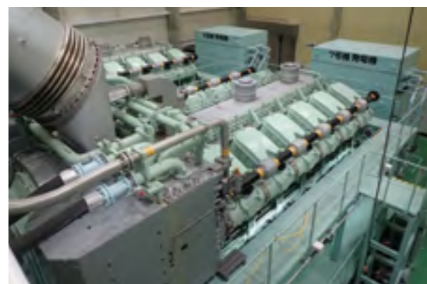
宮古第二発電所6、7号機
