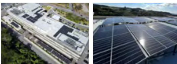
南城市庁舎(2024年12月運用開始) ■太陽光発電設備:105kW ■蓄電池:13.5kWh ■CO 2 削減量:138t/年
