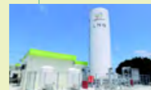
牧港LNG供給センター
