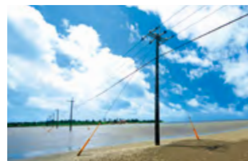
由布島へ続く配電線路
