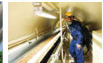
木質バイオマス供給設備(コンペア内)
