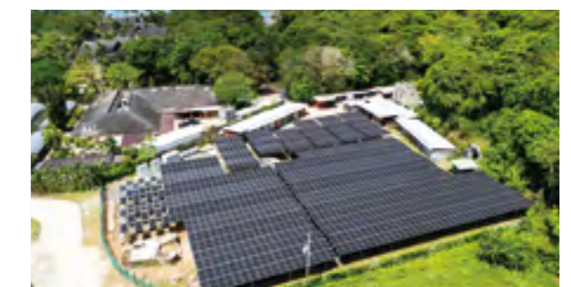
リゾートホテルの再エネ設備
