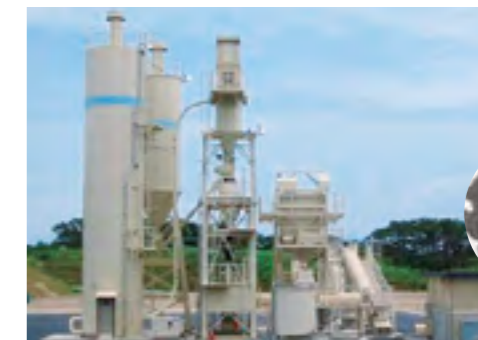
頑丈土製造プラント(土砂代替材製造)
