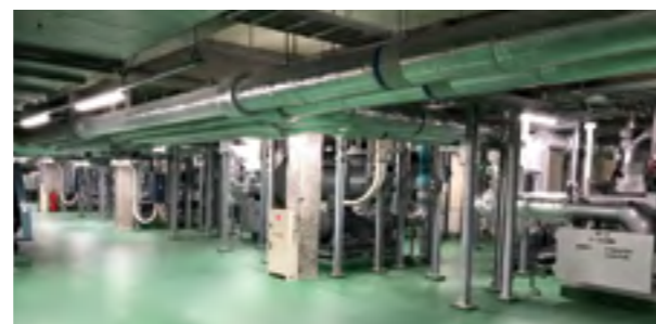
サンエー浦添西海岸PARCO CITY敷地内エネルギー設備：(株)リアリانسエナジー沖縄
