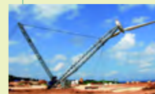
可倒式風力発電設備(波照間)
