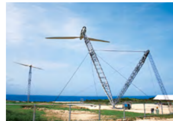
波照間可倒式風力発電設備
