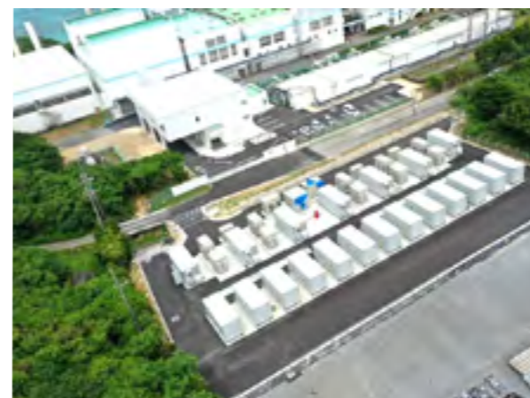
宮古第二発電所供給用蓄電池
