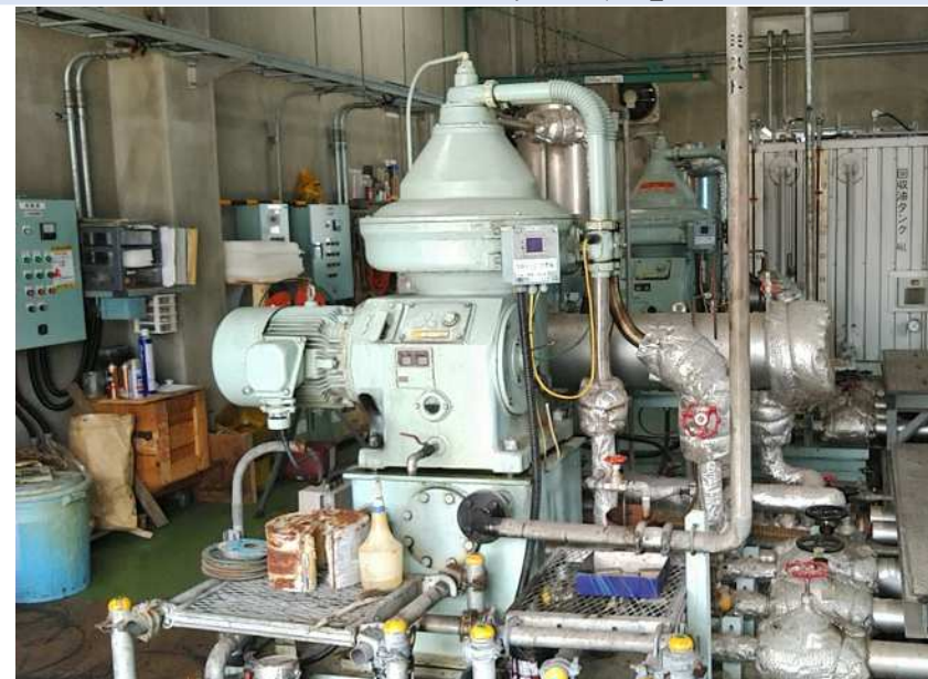
◀ 廃油再生装置による廃油の燃料転換 ▶ 【石垣第二発電所】
