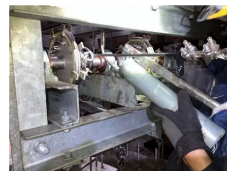
滑落防止装置 点検・グリスアップ
