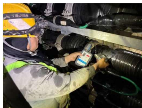
部分放電測定
