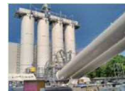
バイオマス混焼設備
