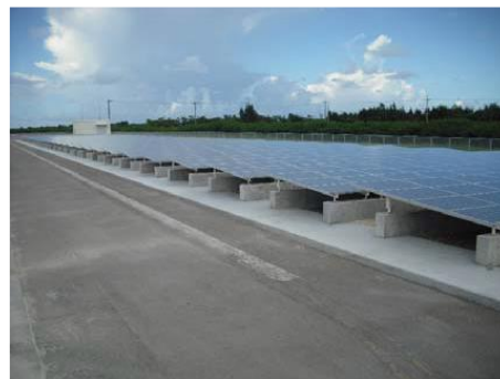
多良間島太陽光発電実証研究設備
