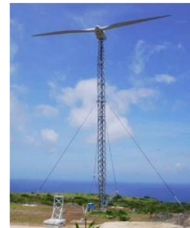
粟国可倒式風力発電設備
