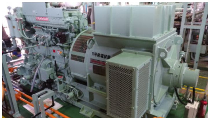
ディーゼル発電設備 外観（写真は11号機）
