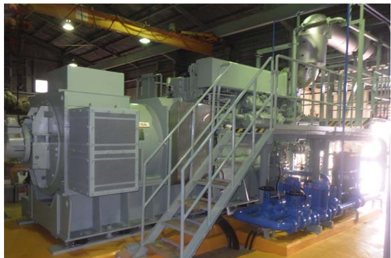
10号機発電設備 外観
