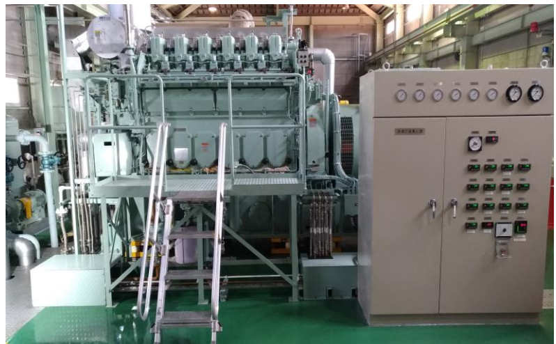
8号機発電設備 外観
