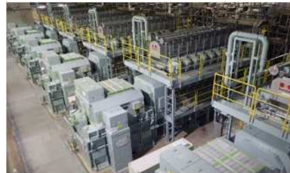
← ガスエンジン発電設備
