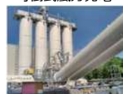
バイオマス混焼設備
