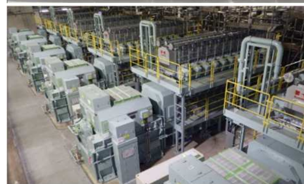
← ガスエンジン発電設備
