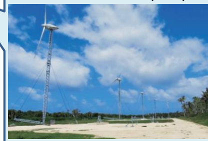
可倒式風力発電設備(トンガ)
