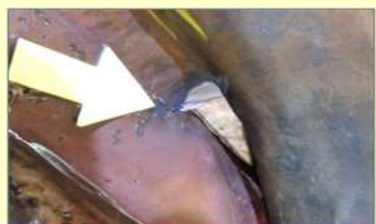
石川2号ボイラ天井管リークを確認
