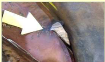
石川2号ボイラ天井管リークを確認
