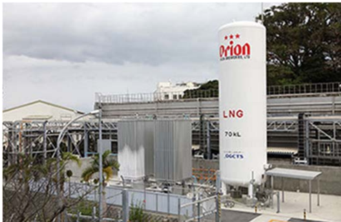
LNG satellite facilities ▲
