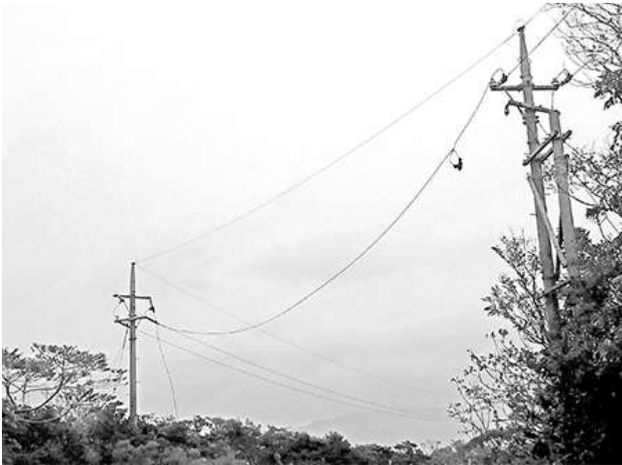
高圧線の断線
