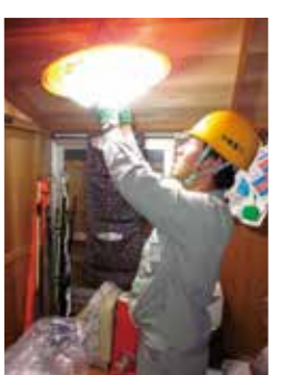
▲地域奉仕活動 (電気設備無料点検)
