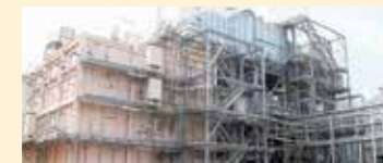
▲排煙脱硫装置
