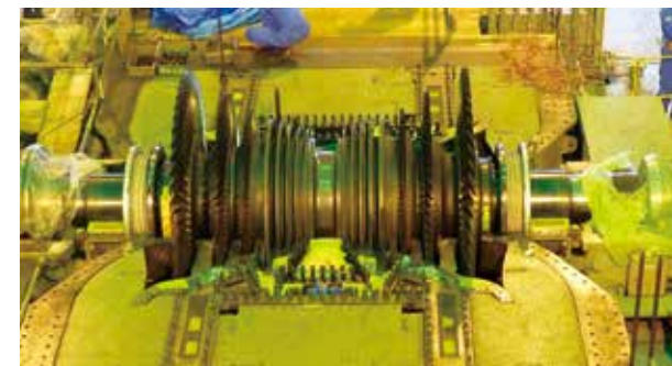
▲長寿命化対策工事をを行った石川火力発電所2号機の蒸気タービン
