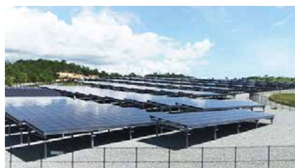
▲あぶメガソーラー実証研究設備(名護市)
