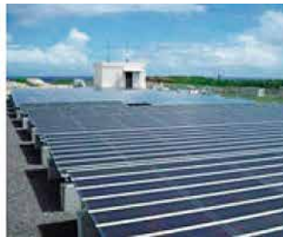
・太陽光発電 150kW ・リチウムイオンキャパシタ 150kW
