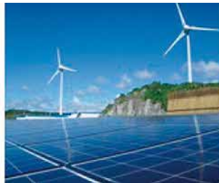
・太陽光発電 4,000kW ・ナトリウム硫黄電池 4,000kW ・リチウムイオン電池 100kW
