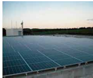
・太陽光発電 100kW ・リチウムイオンキャパシタ 100kW
