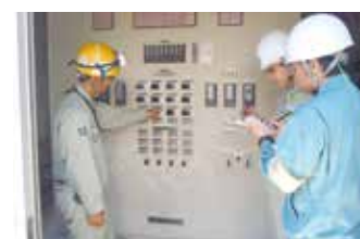
▲古の浦火力発電所での実習風景
