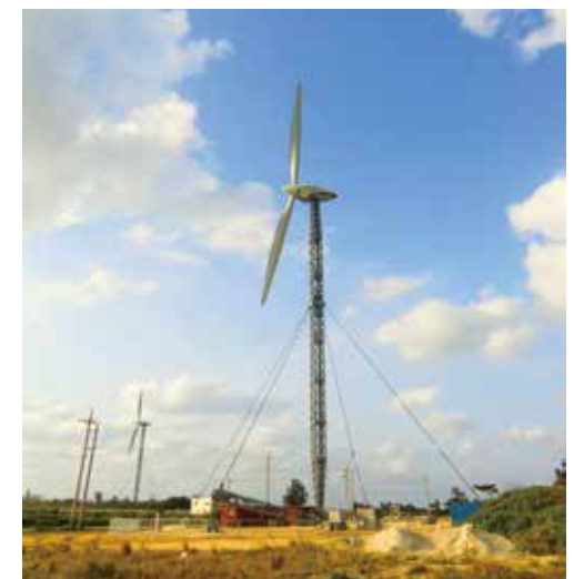
▲可倒式風力発電システム(多良間島)
