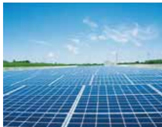
離島独立型新エネ導入実証事業 (多良間)
