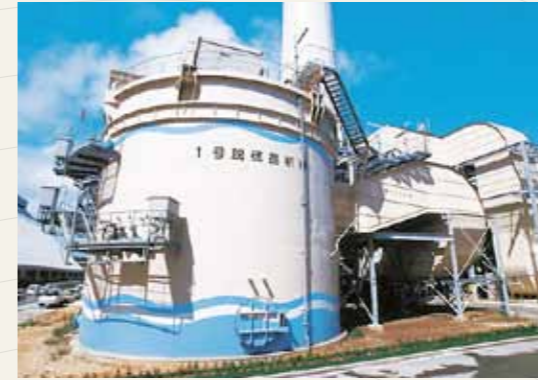
環境保全対策設備
