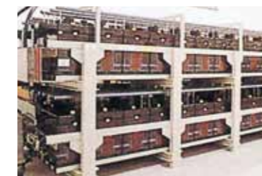
電力貯蔵システム
