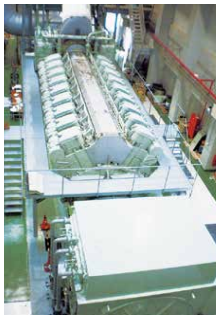
石垣第二発電所 (ディーゼル発電機)
