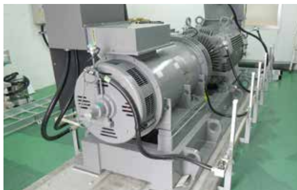
波照間島MGセット実証研究設備
