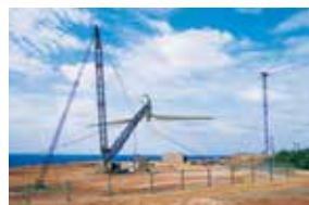
可倒式風力発電設備（南大東島）
