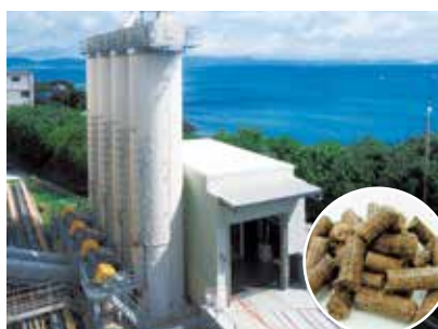
木質バイオマス供給設備
