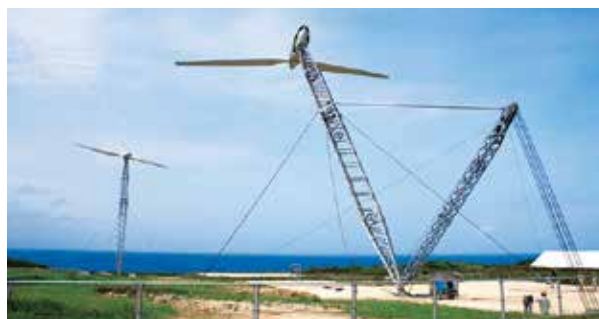
波照間可倒式風力発電設備
