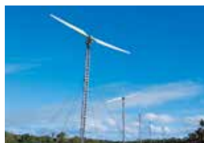
トンガ: 可倒式風力発電所(275kW×5基)
