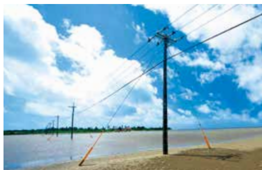
由布島へ続く配電線路
