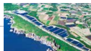
メガソーラー実証研究設備
