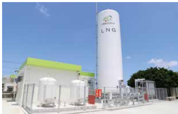
牧港天然ガス供給センター：(株)プログレッシブエナジー （設計：(株)沖縄エネテック・施工（基礎工事）：(株)沖電開発）
