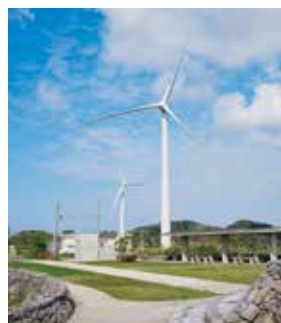
大宜味風力発電実証研究設備 (大宜味村 石山展望台から撮影)
