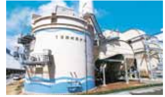
発電所の大気保全対策設備 燃焼によって生じる硫酸酸化物や窒素酸化物、ばいじんを低減するため、さまざまな大気保全対策を講じています。
