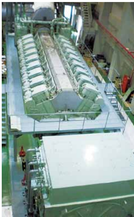
石垣第2発電所(ディーゼル発電機)
