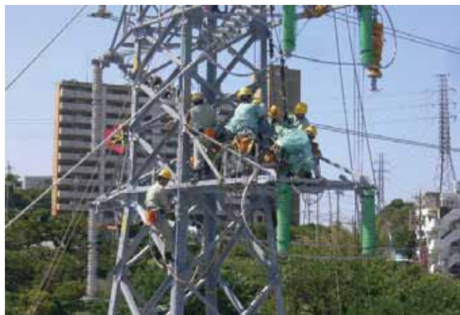
電力設備の復旧訓練
