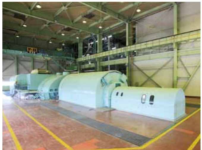
蒸気タービン
