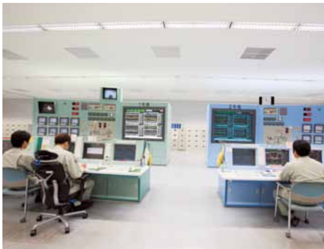
金武火力発電所中央操作室
