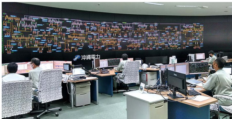
▲電力系統の運用監視
