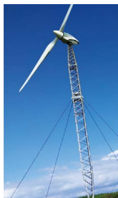
▲可倒式風力発電設備
