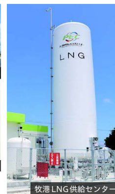
牧港 LNG 供給センター
