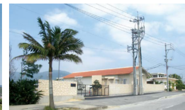
名蔵配電塔（石垣島）
