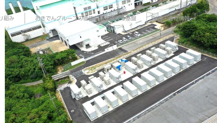
▲ 宮古第二発電所供給用蓄電池
