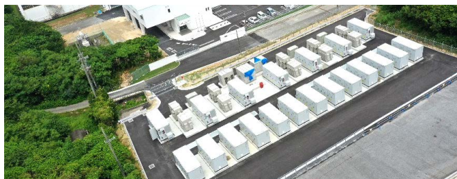
▲宮古第二発電所供給用蓄電池
