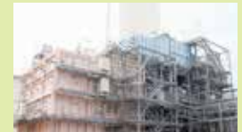
排煙脱硫装置
