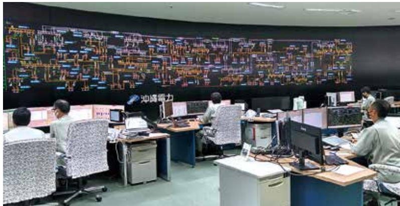
▲電力系統の運用監視
