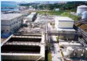
総合排水処理装置
