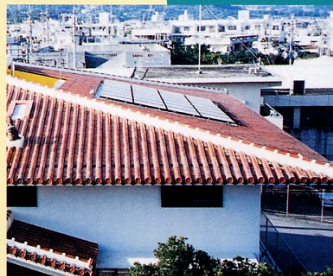
屋根につけられた太陽光発電システム
