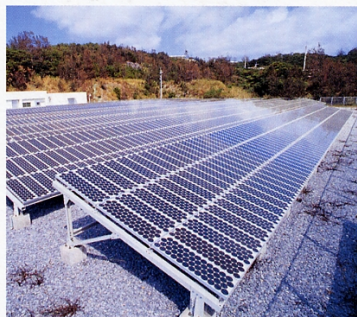
渡嘉敷島での太陽光発電システムの実証研究
