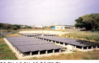
北大東太陽光発電システム
