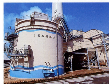
排煙脱硫装置(具志川火力発電所)
