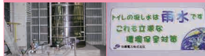
▲雨水を回収しトイレの流し水に利用(金武火力、宮古支店、八重山支店)
