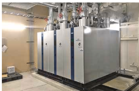
蒸気ボイラー (3台)
