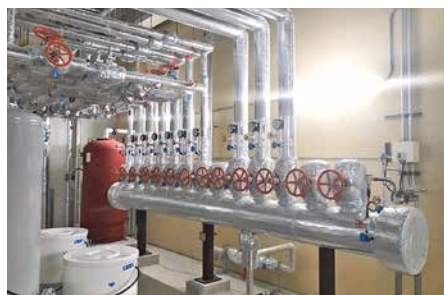
蒸気ヘッダー
