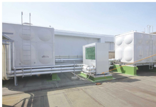
【屋上】高効率高温水ヒートポンプと貯湯槽 (2台)
