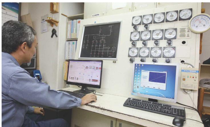
【中央監視室】監視操作盤
