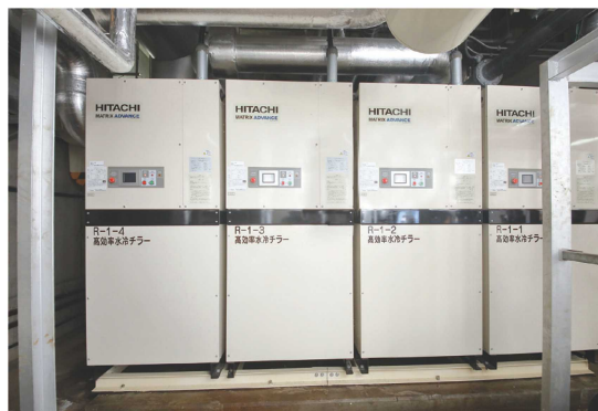
【機械室】高効率水冷チラー (4台)
