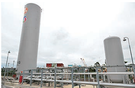
LNGサテライト設備
