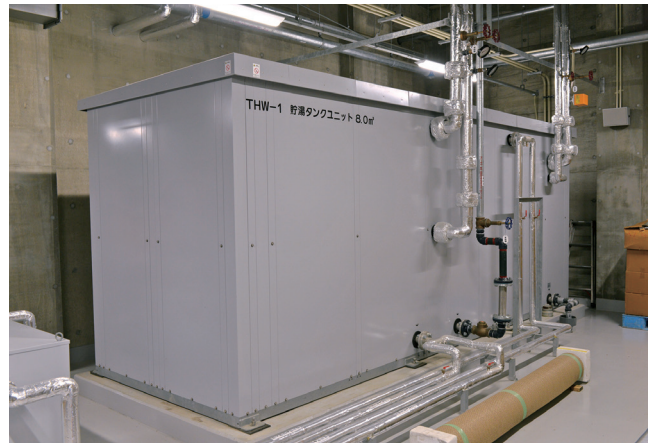
貯湯槽（8t×2基）
